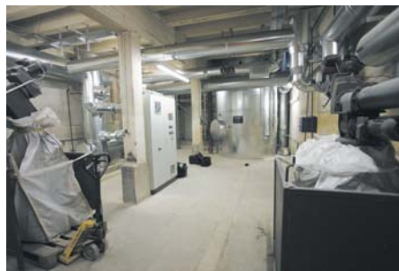
Heizzentrale der zfp Münsterklinik Zwiefalten
