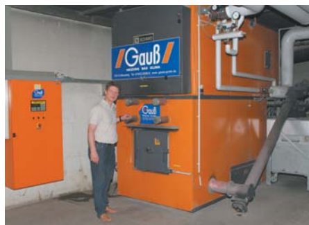
Hackschnitzel-Heizung im Otto-Hahn-Gymnasium
